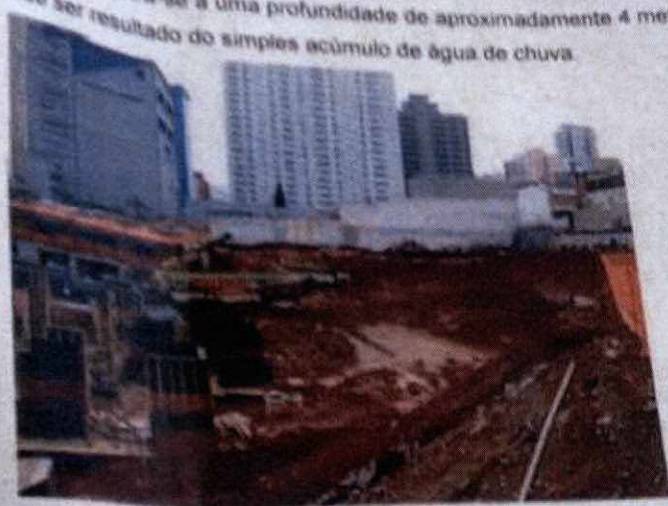
Foto 4 – Acúmulo de água em local escavado no interior do terreno: acumulação de água de chuva mais água subterrânea atingida por escavação. Não há área de preservação permanente.
