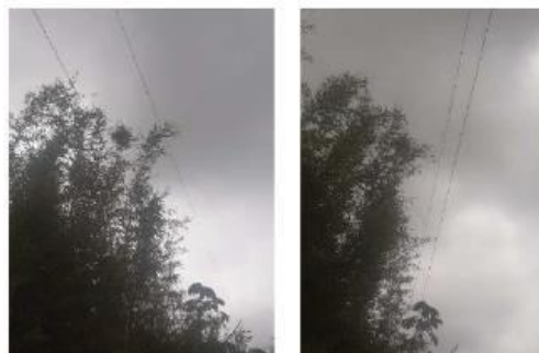
Fotos retiradas do local do acidente na diligência pericial (07/10/2022), ainda há vegetações próximas da rede elétrica.
